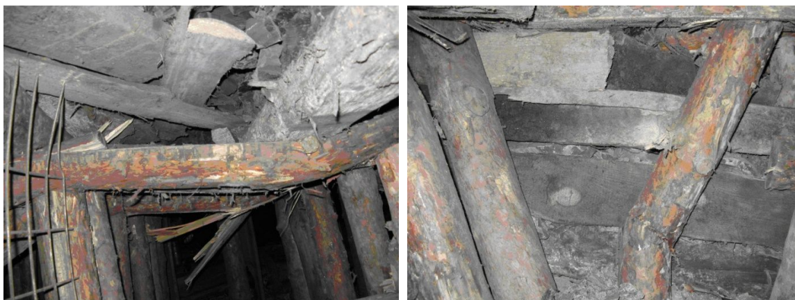
Рис. 5– Загальний вигляд деформування елементів дерев'яного кріплення внаслідок їх неякісної установки
