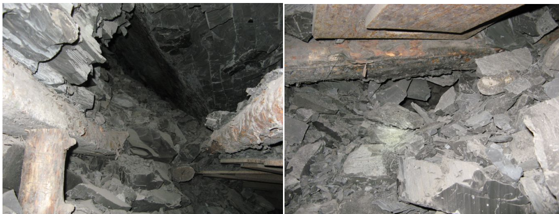
Рис. 4– Загальний вигляд обвалення порід покрівлі позаду секцій кріплення зі зворотною консоллю
