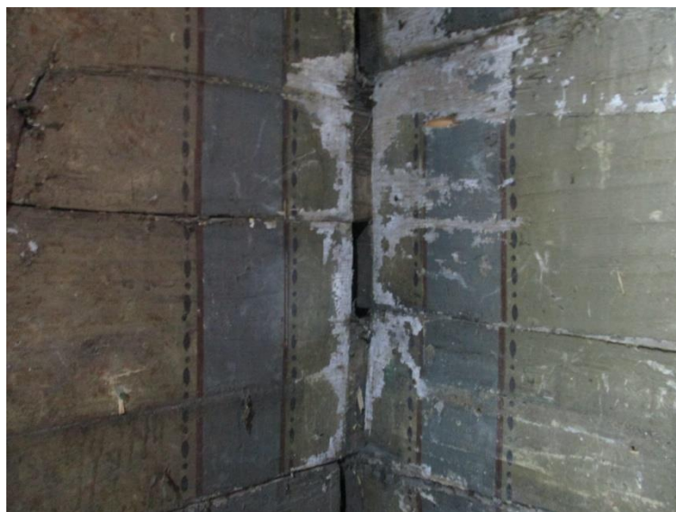
Рис. 2. Місця ушкодження стін пліснявими грибами у храмі
