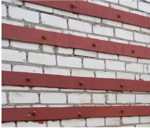
Рис. 3. Фрагмент цегляної кладки стіни яка була посилена сталевими смугами
