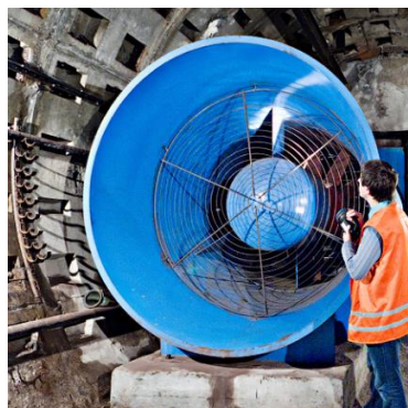
Рис. 1. Фото вентиляційної установки у вентиляційному тунелі
