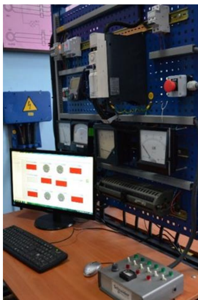
Рис. 1. - Стенд з частотним перетворювачем Altivar компанії Schneider Electric .
