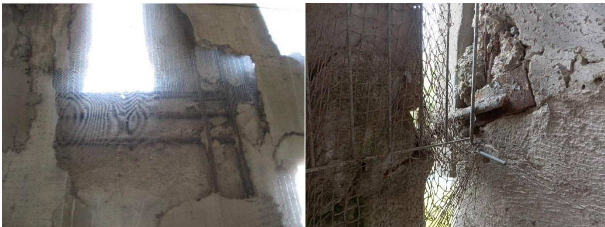
Рис. 2. Порушення зв'язку між закладними деталями
