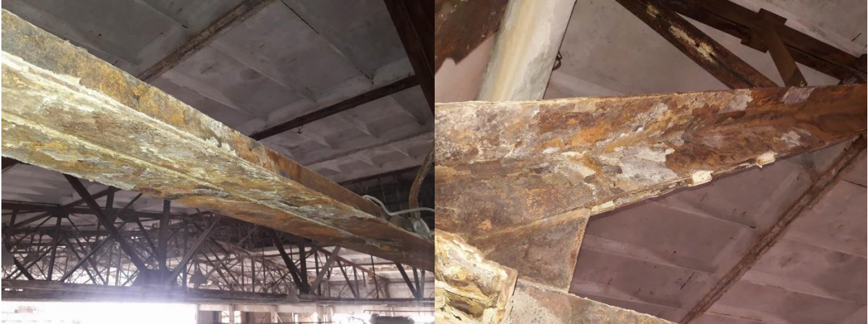
Фото 1, 2. Пластова корозія елементів ферми покриття
