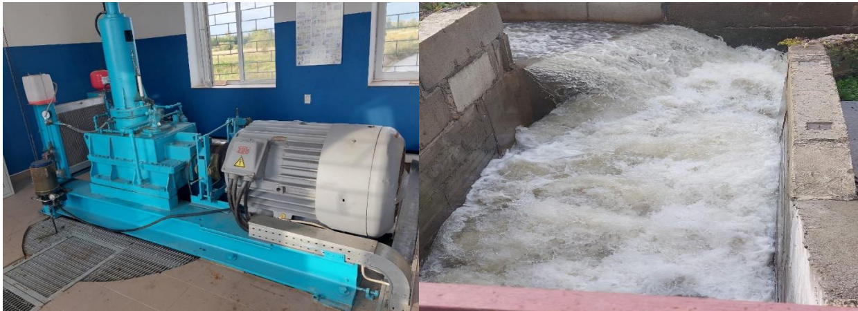
Мал. 1. Гідралічний турбінний генератор для міні-ГЕС Мал. 2 Канал-шлюз на міні-ГЕС
