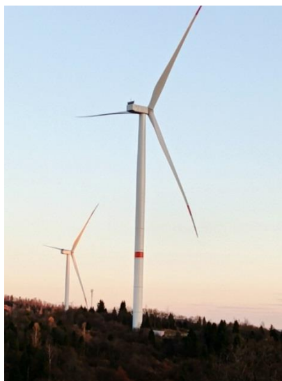
Рис. 1. Діючі турбіни Нижньоворітської вітрової електростанції (Світлина С. Поп, листопад 2025 р).
