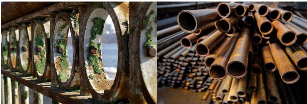
Рис. 1. Приклади корозії будівельних конструкцій та матеріалів [2]
